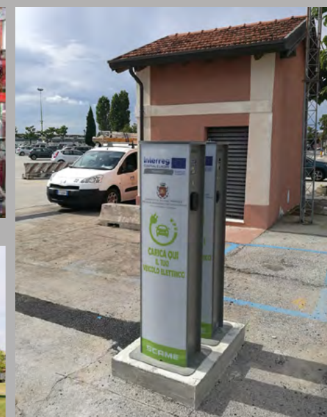
Autorità Portuale di Venezia: colonnine di ricarica auto elettriche
