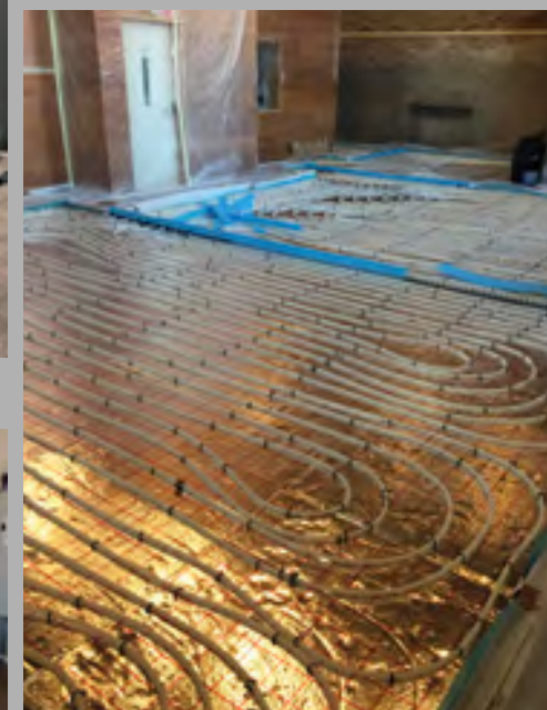
Autorità portuale Venezia: impianto di riscaldamento radiante chiesa S. Marta (VE)
