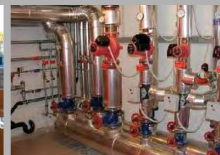
Manutenzioni locali CT
