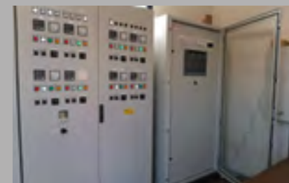
Veritas Ponte Crepaldo: automazione impianto depurazione con plc SIEMENS
