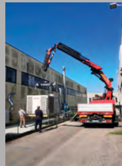
Privato: nuova installazione Roof Top Trane
