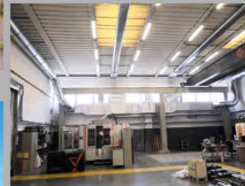
Privato: impianto canalizzato microforato climatizzazione
